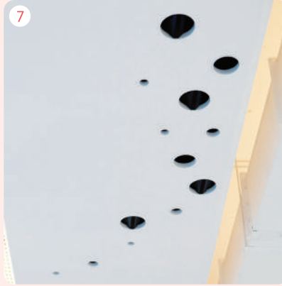
空調の吹き出し口 ショップやカフェなどの交流スペースでは、天井にある空調の吹き出し口が丸くデザインされています。
